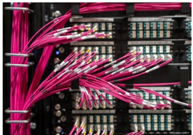
Mehr als 51 Kilometer Kabel wurden für das Rechenzentrum verlegt.
