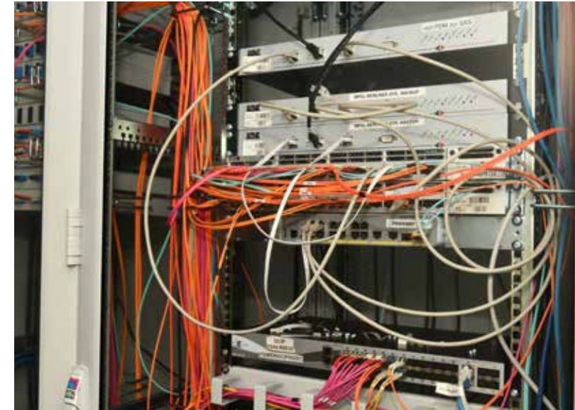
Zahlreiche Kabel laufen am Server zusammen.
