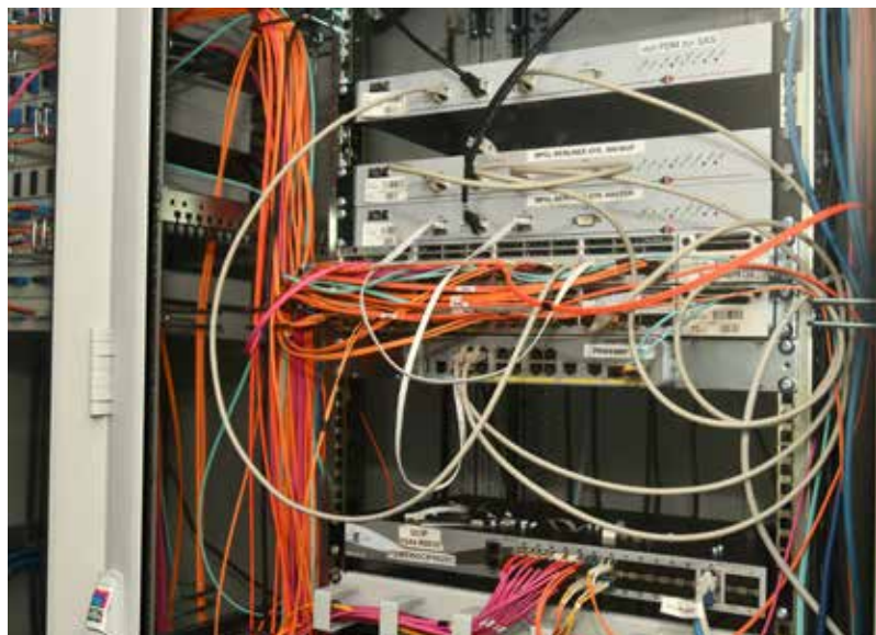
Zahlreiche Kabel laufen am Server zusammen.
