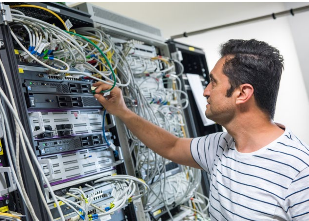
Aufgabe für Experten: Installation eines Servers
